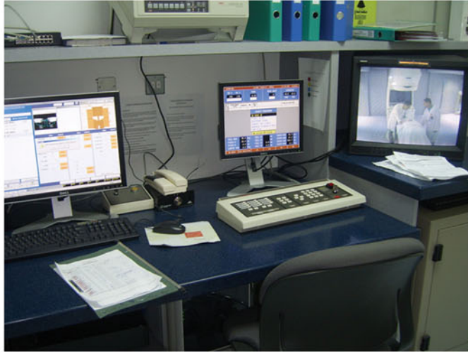
صورة لغرفة التحكم
